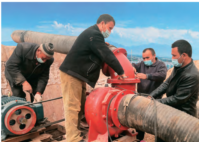
昌吉学院驻柯坪县阿恰勒镇团结村“访惠聚”工作队队员帮助村民安装灌溉设备。 □刘小辉/摄
