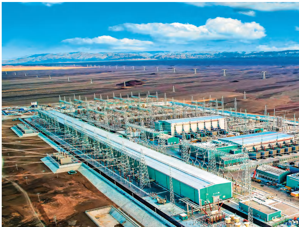
哈密—重庆±800千伏特高压直流输电工程巴里坤换流站全景。
